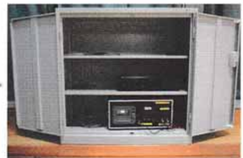
新設の音響設備
