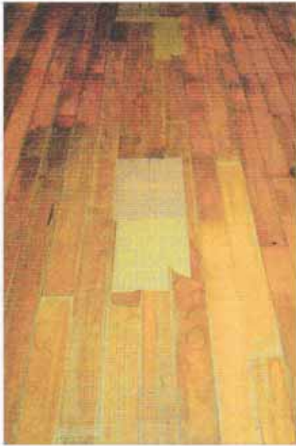
ガムテープで補修した床
