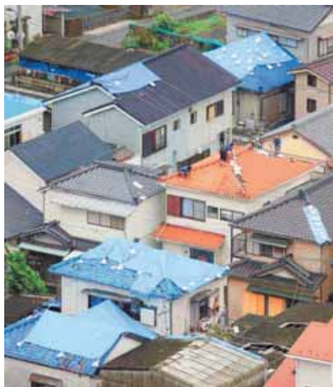
令和元年 台風15号による 屋根の被害
